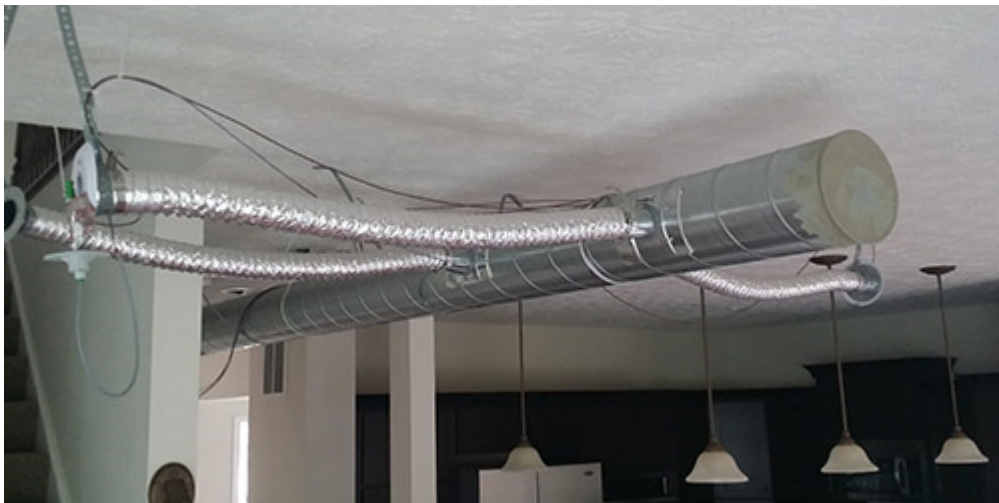
Dans sa maison laboratoire de Pittsburgh, IBACOS a testé la performance d'un système de chauffage qui utilise des conduits de 2,5 pouces de diamètre
